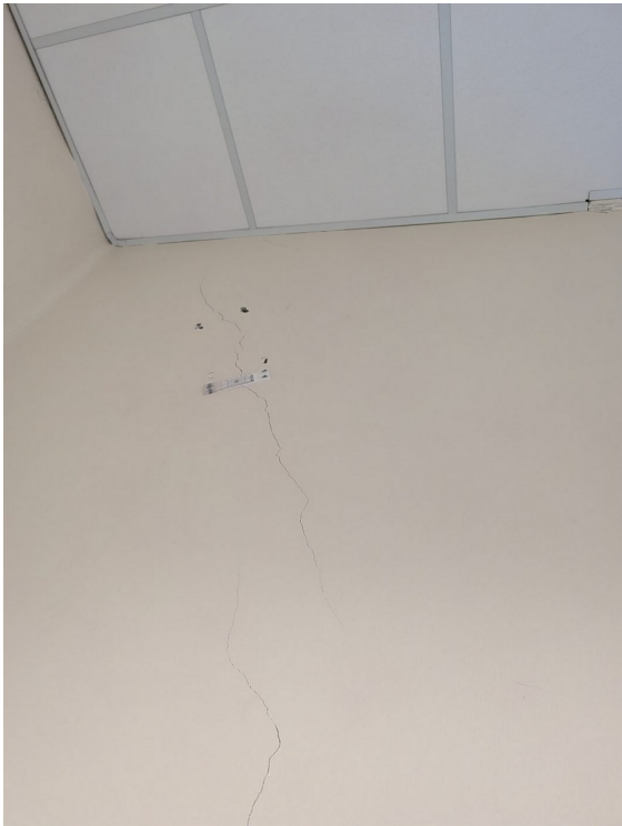
Foto 32 - Fessurimetro F04 - camera 4: vista d'insieme della lesione che si sviluppa dal soffitto lungo la parete.
