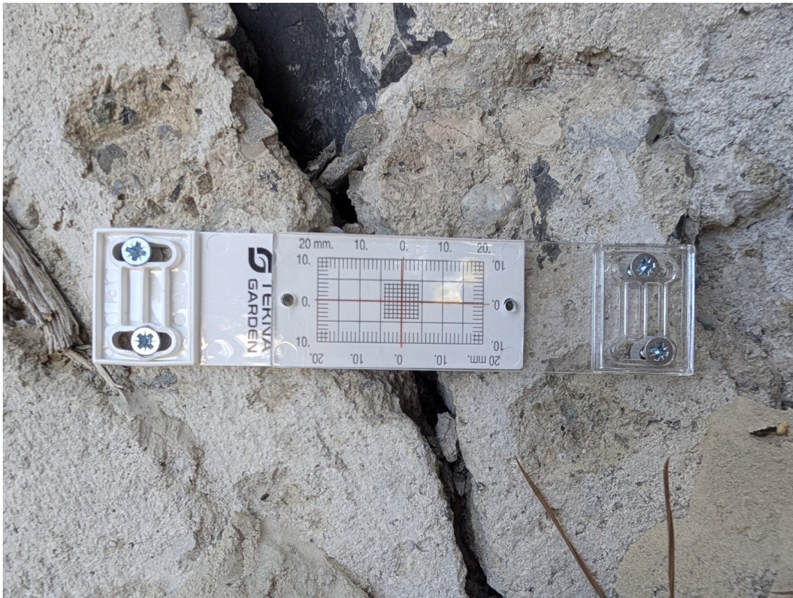
Foto 13 – Fessurimetro F02-EXT installato tra i prismi P01-R e P02-R su lesione con ampia apertura e intonaco distaccato.
