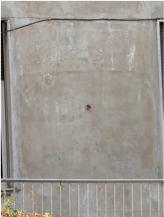
Foto 19 – Prisma P09 – piano terra, muratura a destra della pensilina d'ingresso centrale, sopra la ringhiera.
