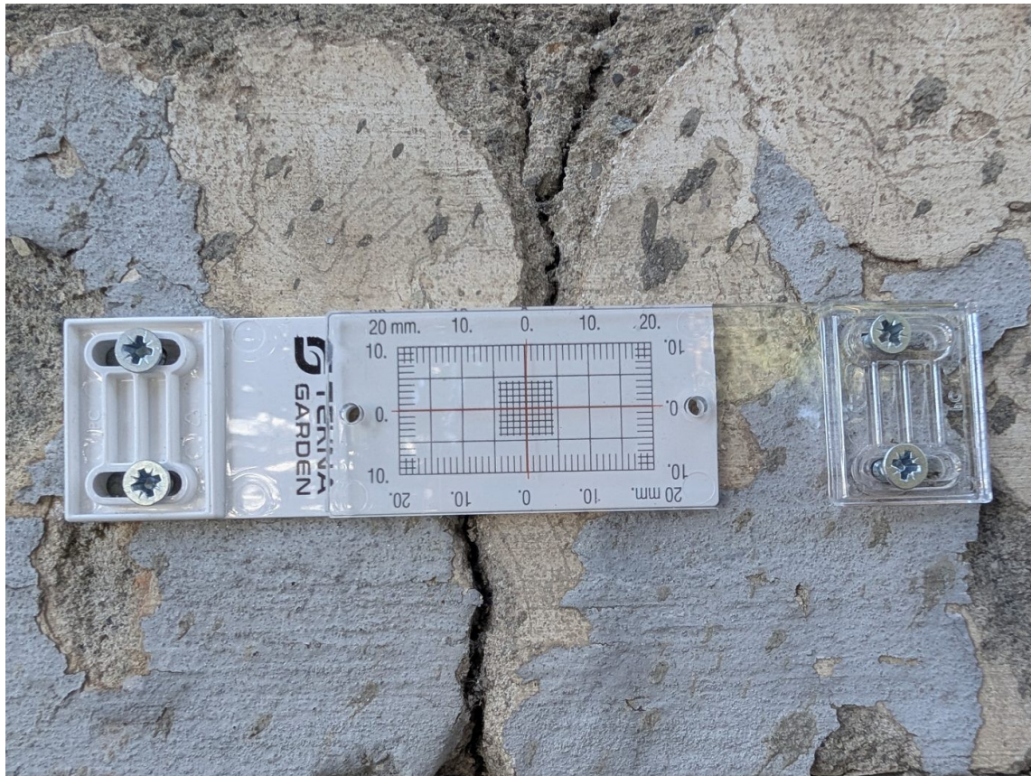
Foto 12 - Fessurimetro F01-EXT installato tra i prismi P01-R e P02-R su lesione passante dell'intonaco, con distacchi diffusi.
