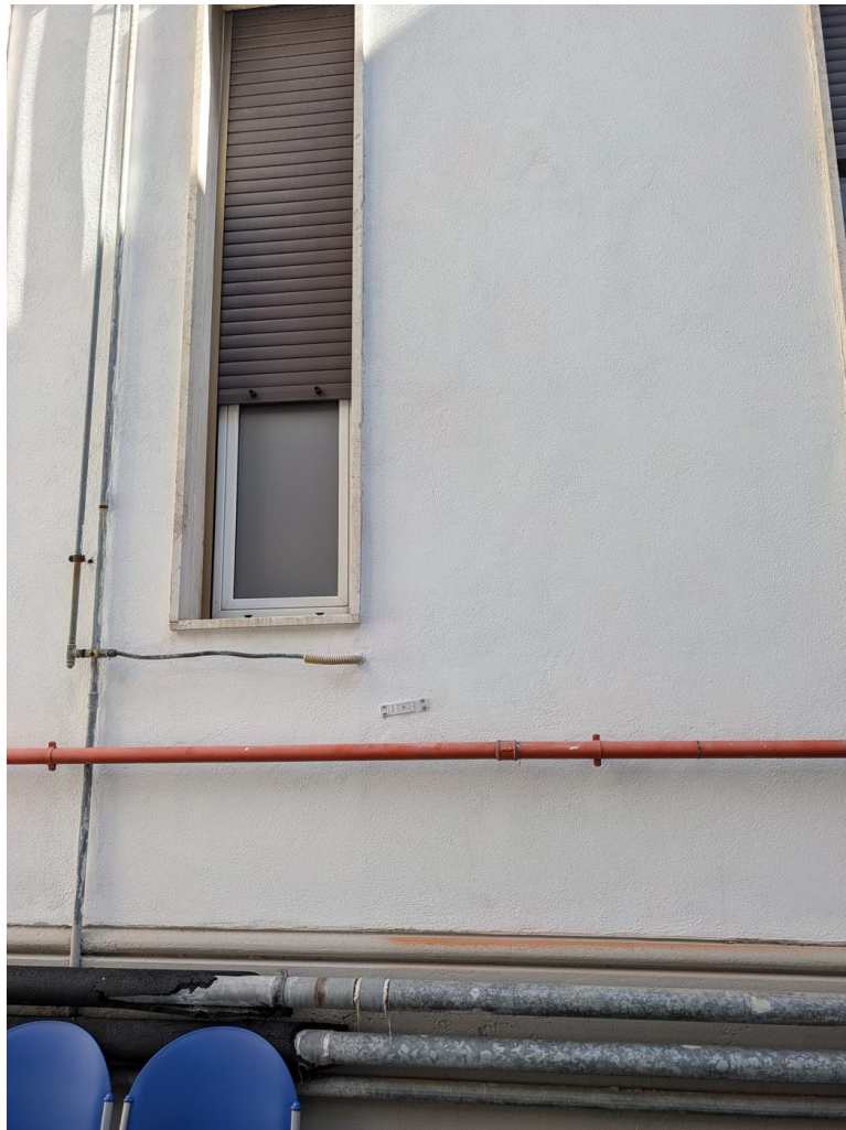
Foto 33 - Cortile interno - parete al piano terra su cui è installato il fessurimetro F05-CORTILE, al di sotto della finestra.
