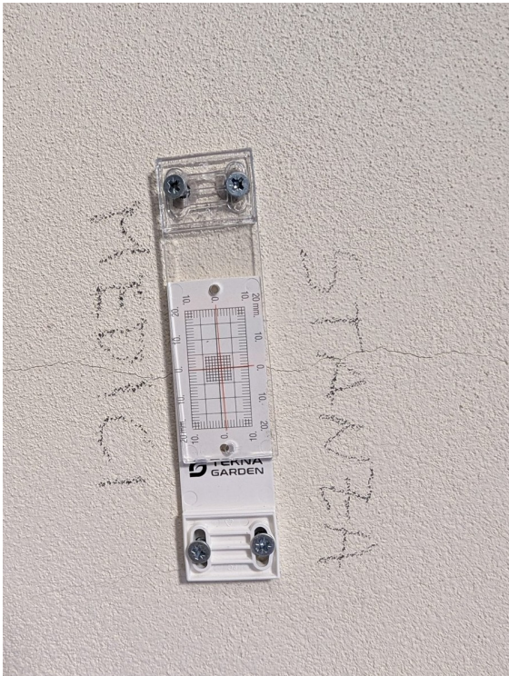
Foto 25 – Fessurimetro F03 – sala medici: lesione verticale sulla parete, con annotazione della posizione.
