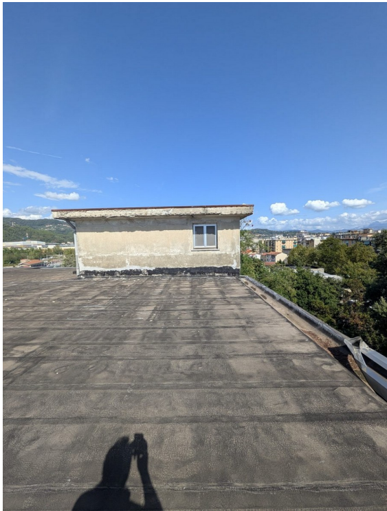
Foto 9 – Copertura piana dell'edificio dei riferimenti: torretta con intonaci degradati e lesionati alla base.
