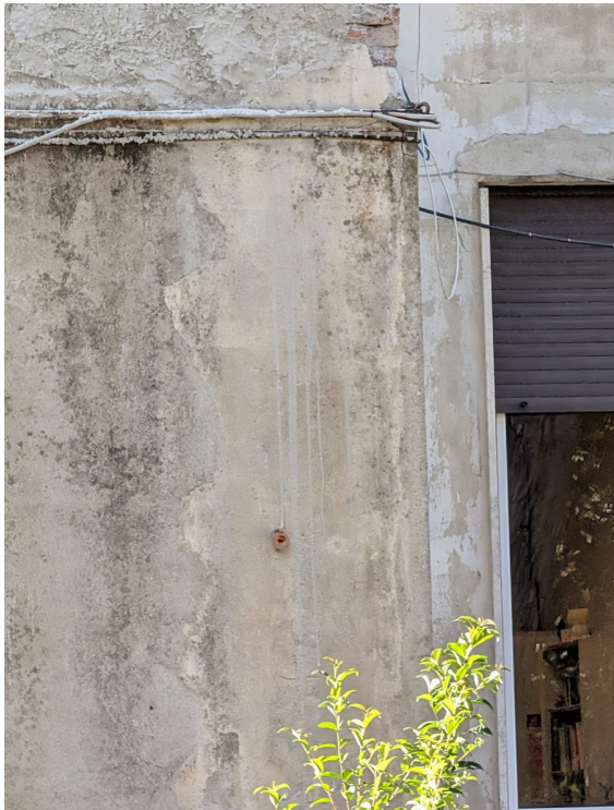
Foto 18 – Prisma P08 – piano terra, muratura a sinistra della pensilina d'ingresso centrale.
