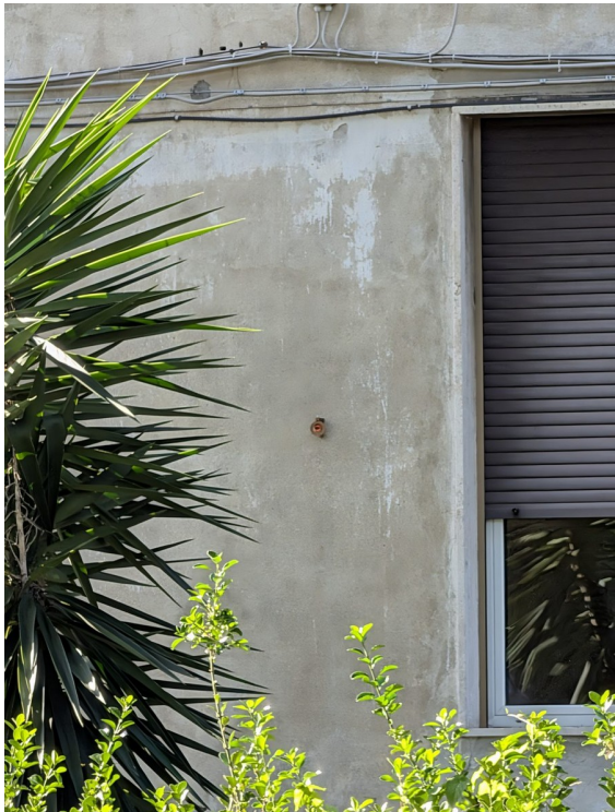
Foto 16 – Prisma P06 – piano terra, muratura a fianco della finestra, porzione sinistra del fronte.
