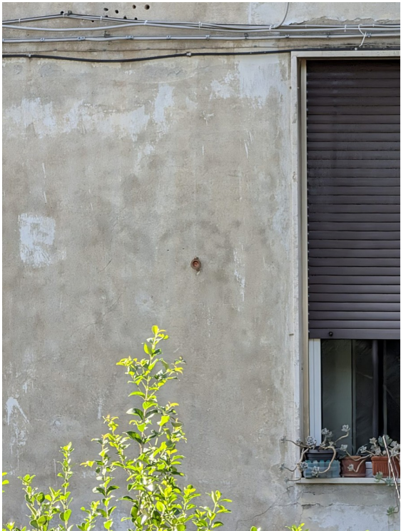
Foto 17 – Prisma P07 – piano terra, muratura a fianco della finestra, porzione sinistra del fronte.
