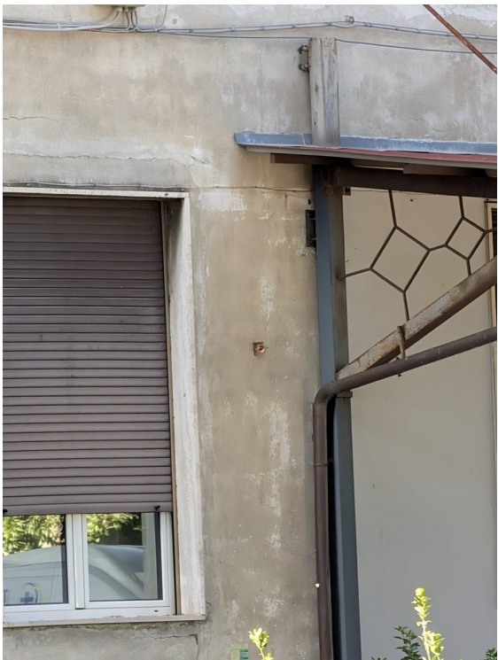
Foto 23 – Prisma P13 – piano terra, muratura a fianco della finestra in corrispondenza della pensilina all'estremità destra.
