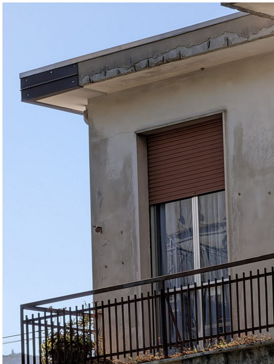
Foto 14 – Prisma P04 – piano primo, a fianco della finestra del balcone all'estremità sinistra del fronte.
