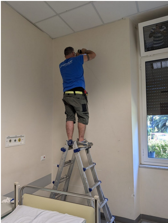
Foto 27 – Camera 4 – fase di installazione del fessurimetro F04 sulla lesione in prossimità del soffitto.
